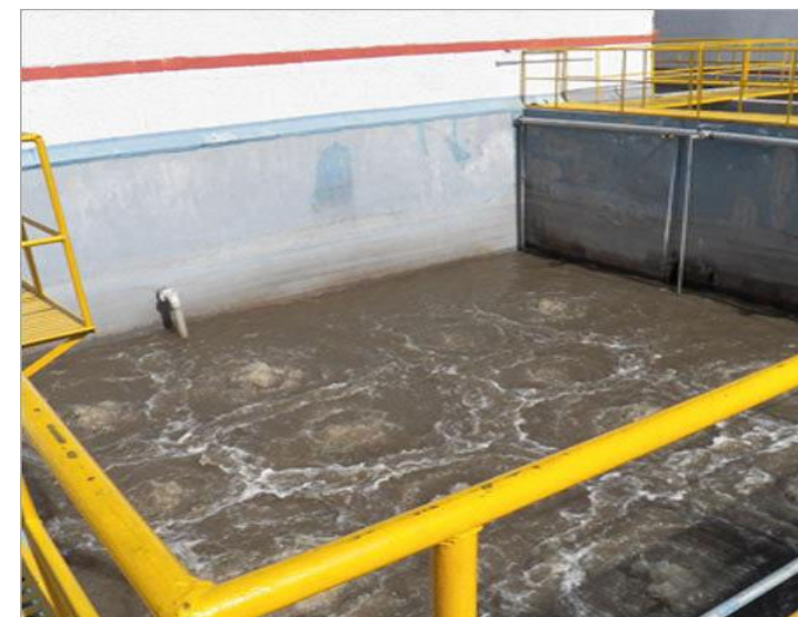
Hình 4.9. Bể điều hòa nước thải
