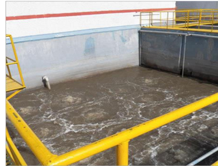
Hình 2. Bể điều hòa nước thải
